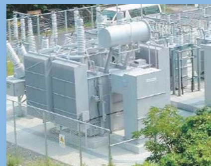
66kV受電設備
