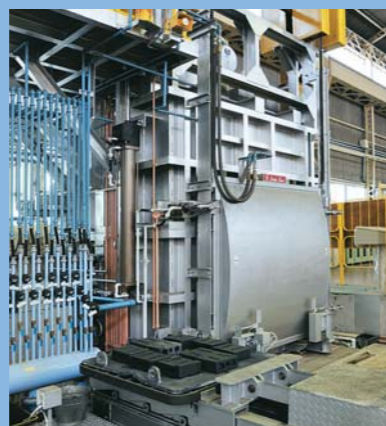
新型焼鈍炉(バッチ型焼鈍炉)の導入
